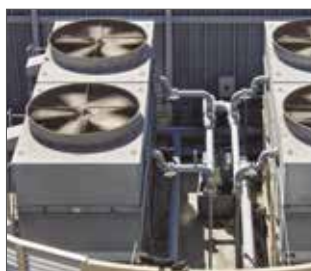
FAN AND PUMP
